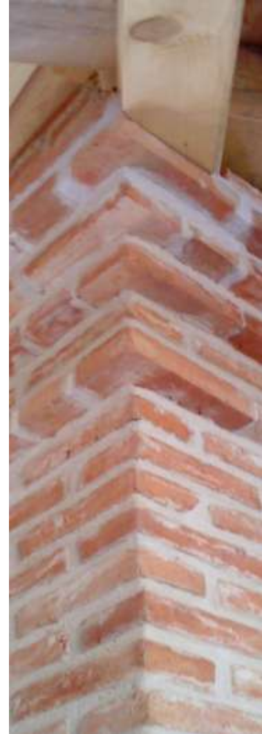
Pilar estructural Cal NHL 5
