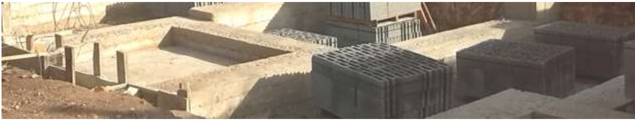
Cimentaciones con hormigón de Cal NHL 5 en una promoción de 14 viviendas (FORMENTERA)
